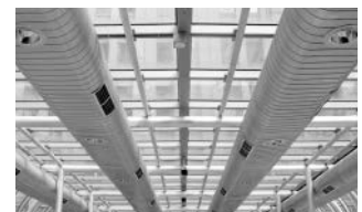
Điều hòa không khí
